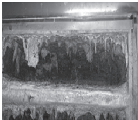
写真-2 鍾乳洞状態になったスクラバー
